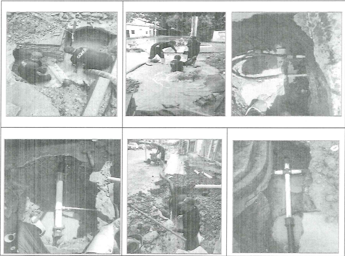
Imagen No.7. Atención a daños de instalaciones domiciliarias
